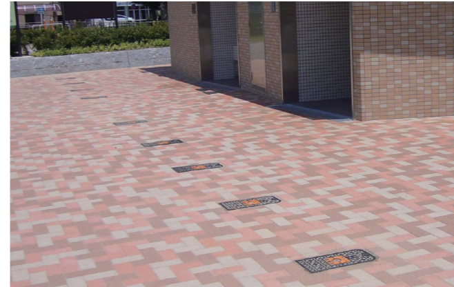
現場名：米野公園 設置場所：名古屋市中村区
