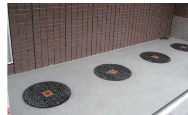
現場名：山形大学体育館 設置場所：山形市
